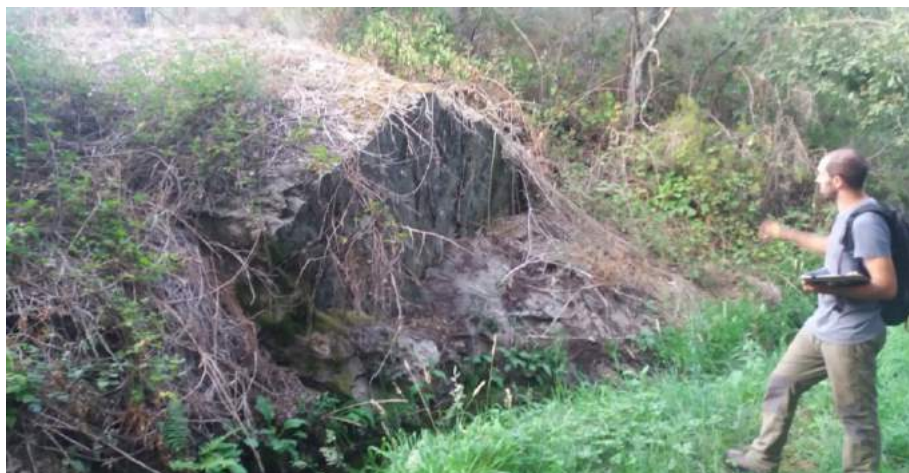
Figura 4.6 – Descarga de Fundo. Talude com xisto aflorante
